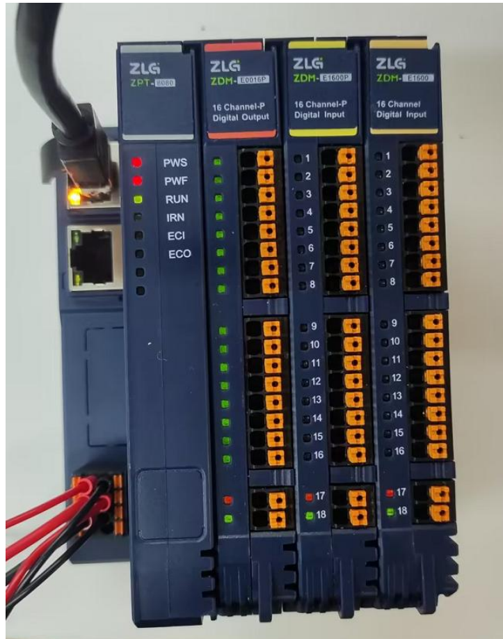
图 5.17 ZPT-8080 通信正常且 ZDM-E0016P 全通道输出有效
